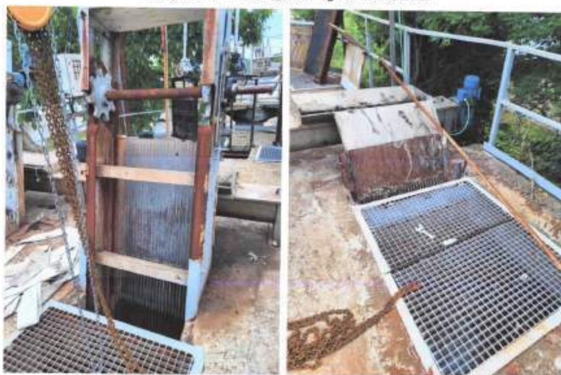
Imagine 11, 12 – Zona gratare- gratare nefunctionale
