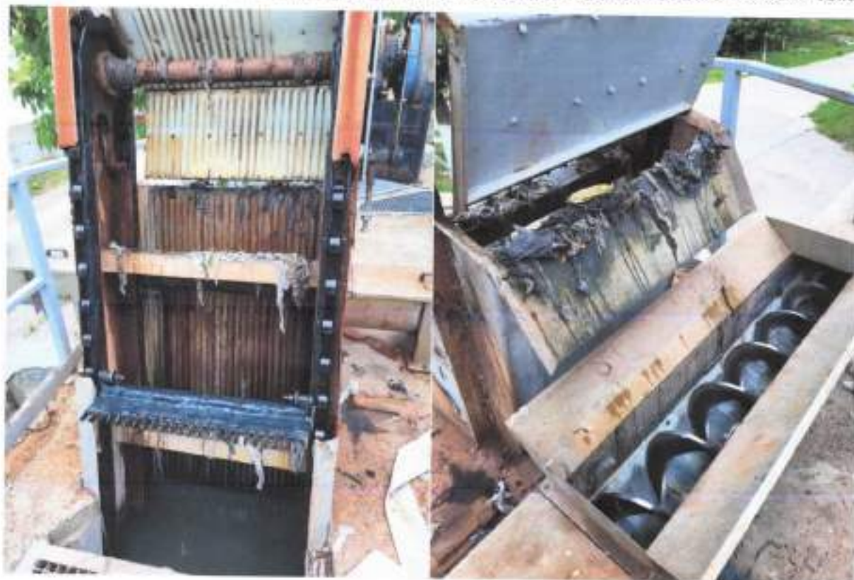
Imagine 9, 10 – Zona gratare- gratar functional
