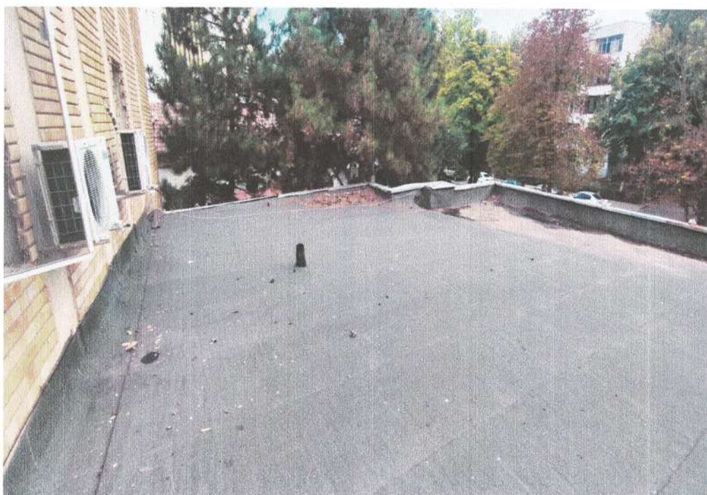
Foto 14 – Aspecte exterioare: Acoperis terasa (degradări locale)
