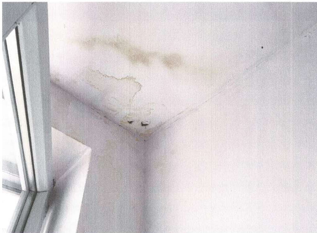
Foto 09 – Aspecte interioare: Pete si infiltratii locale la nivelul tavanului
