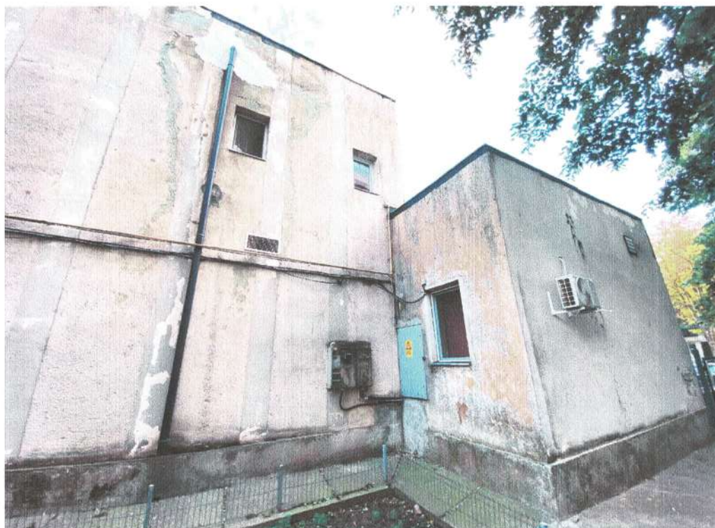
Foto 15 – Aspecte exterioare: Degradari la trotuarului, soclului si fatadei laterale stanga (Tronson I)
