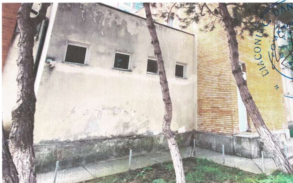
Foto 16 – Aspecte exterioare: Degradari la nivelul finisajelor soclului si fatadei laterale dreapta (Tronson I)
