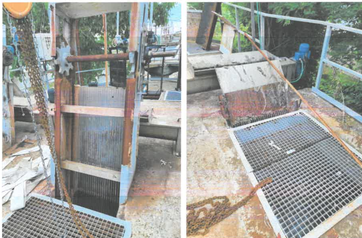
Zona gratare- gratare nefunctionale
