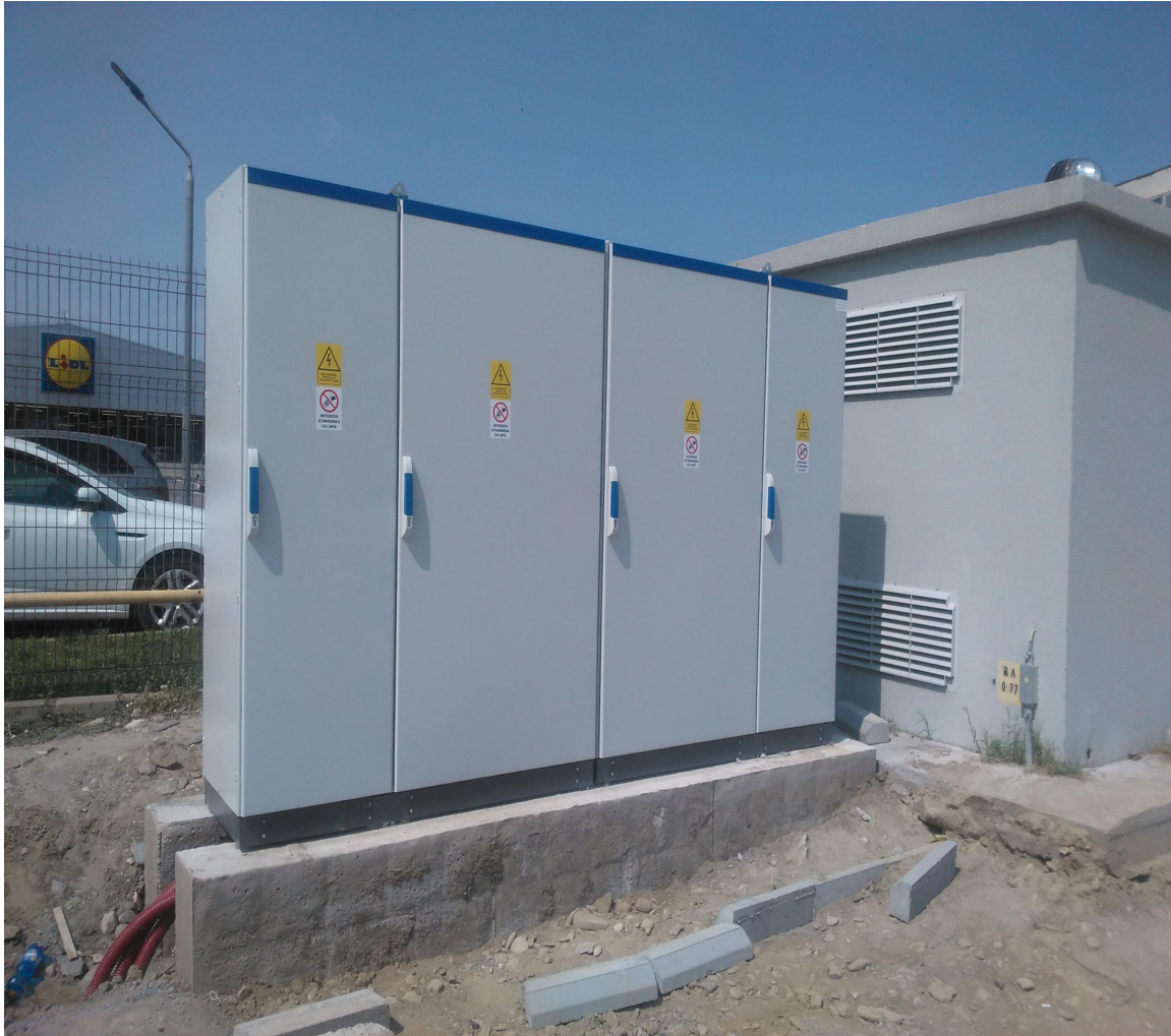
Foto -Stații de încărcare pentru autobuze electrice” Municipiul Slobozia, județul Ialomița (Racorduri electrice)
